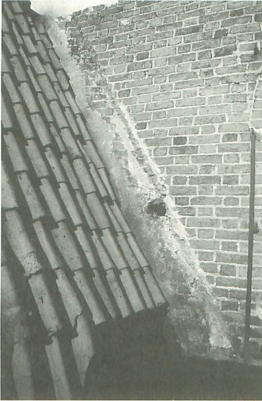
Abb. 6: Wormditt, Pfarrkirche St. Johannes Ev., Südwand des Hochschiffes. Dachwerk (11) mit deutlichen Spuren einer älteren Dachkonstruktion. (Fot. A. KONIECZNY)
