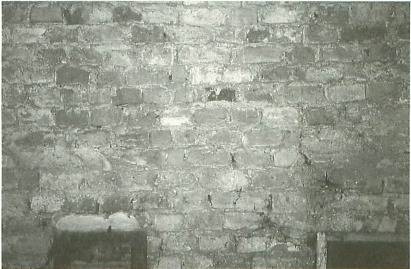
Abb. 15: Wormditt. Pfarrkirche St. Johannes Ev., Kapellengiebel der Südseite am Dachwerk (8), Mauerverband der Innenseite. (Fot. A. KONIECZNY)
